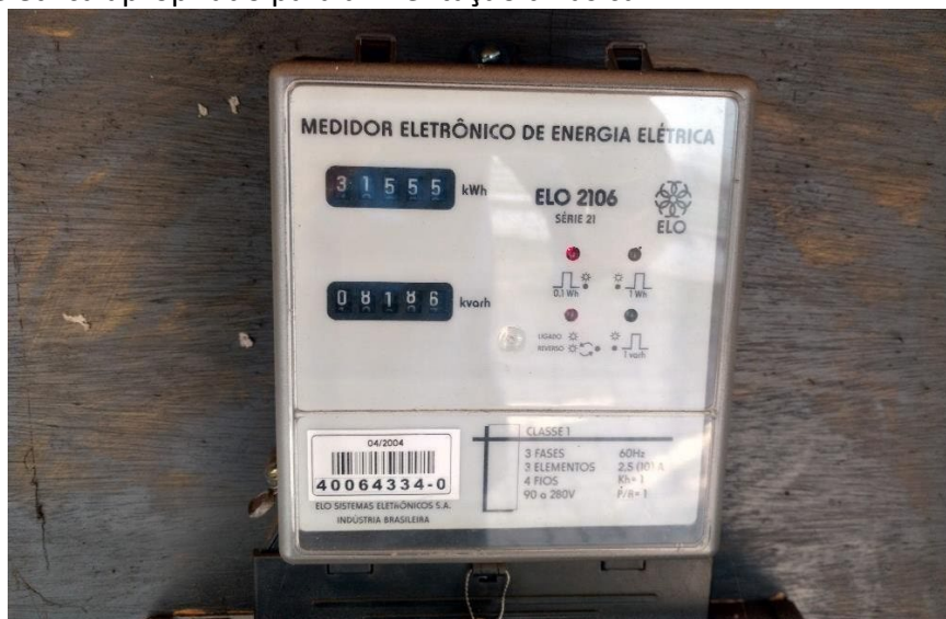
Figura 3.6 – Medidor de energia
