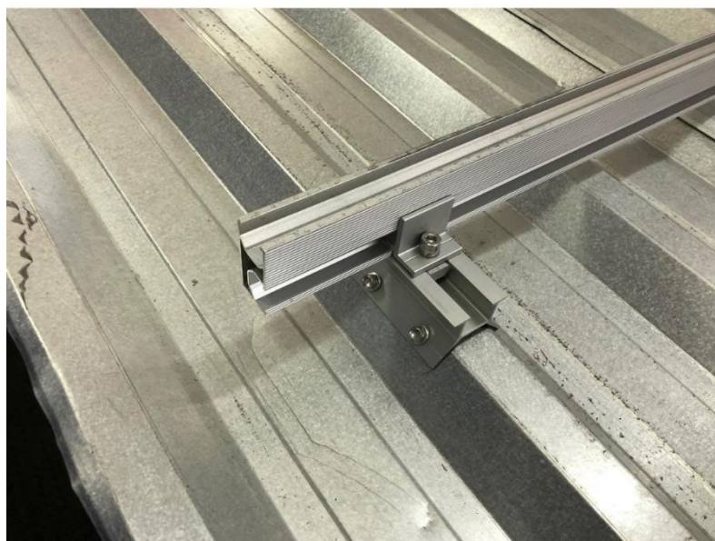
Figura 4.2 – Detalhe de fixação dos módulos
