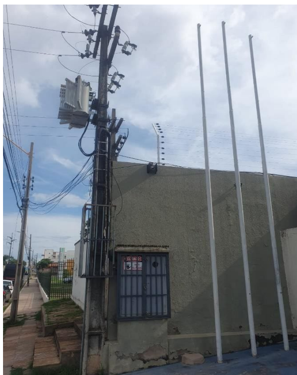
Figura 11.1 – Entrada geral de energia
