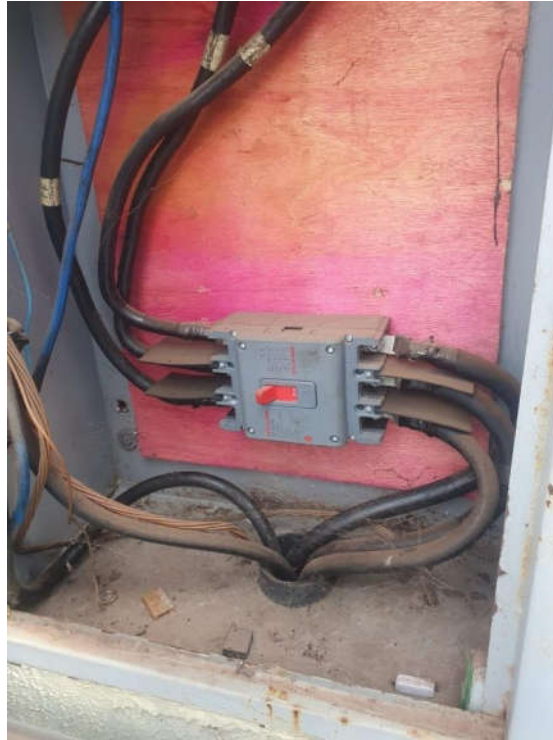
Figura 11.2 – Dispositivo de proteção da entrada de energia
