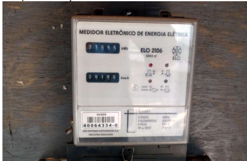
Figura 3.6 – Medidor de energia
