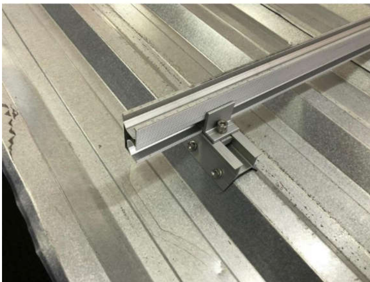
Figura 4.2 – Detalhe de fixação dos módulos
