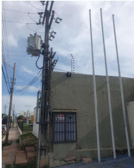
Figura 11.1 – Entrada geral de energia
